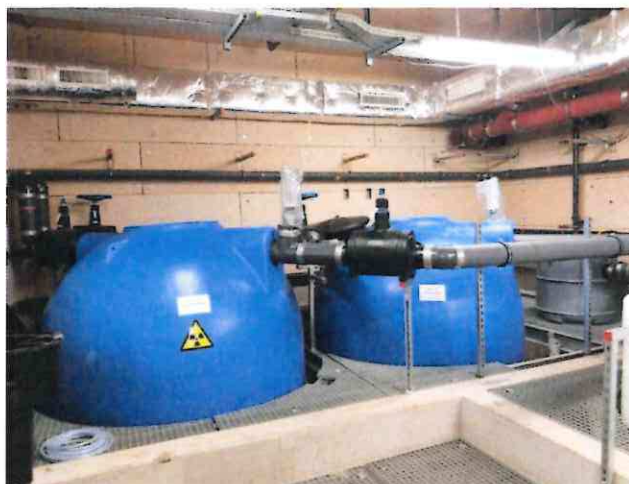
Fig. 12 – Fosses septiques de l'unité de médecine nucléaire
