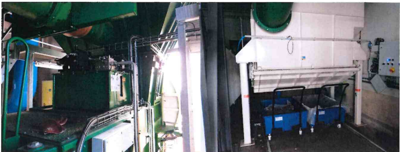
Fig. 8 – Station terminale VIM (à gauche) et trémie de collecte des déchets radioactifs (à droite)
