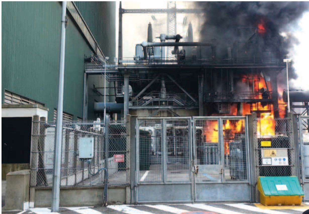
Incendie dans le transformateur de la centrale nucléaire de Cattenom le 7 juin 2013
